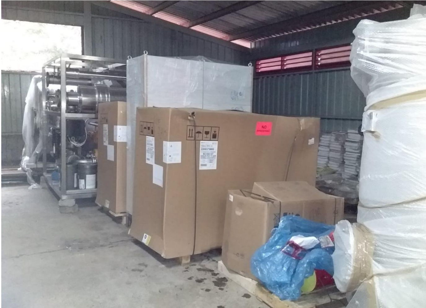
Parte del Equipamiento a instalar.
