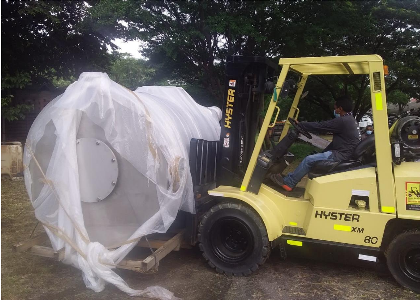
Parte del Equipamiento a instalar
