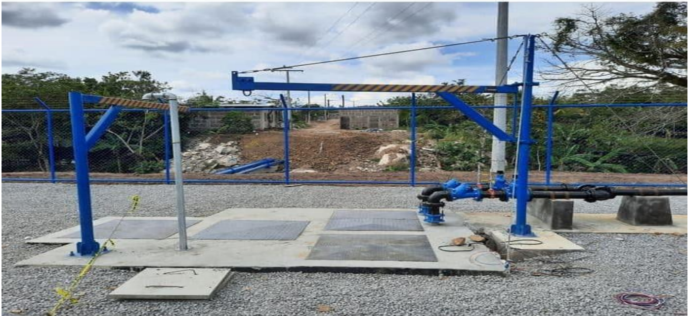
Estación de Rebombeo San José Norte.
