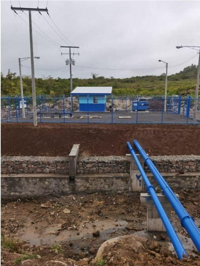
Estación de Bombeo Las Lajitas.
