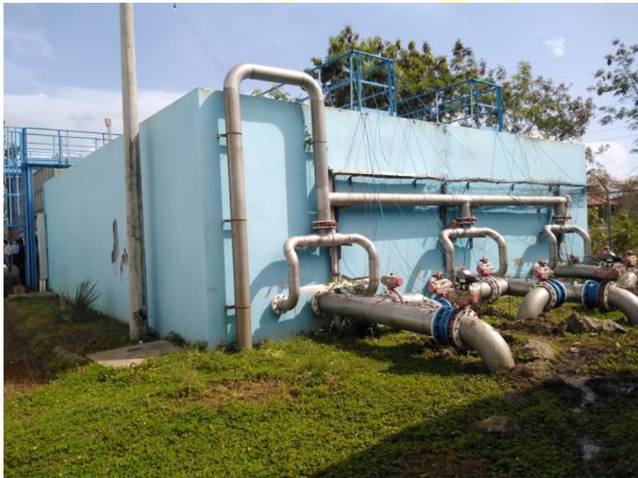
Planta de Tratamiento de San Juan del Sur.
