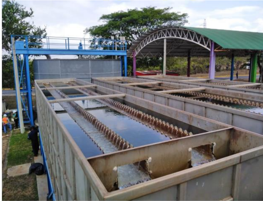
Planta de Tratamiento de San Juan del Sur.
