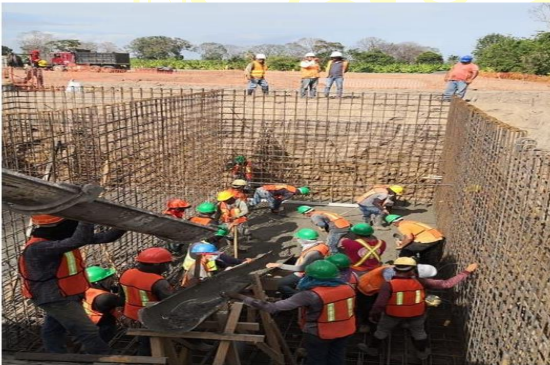
Lechos de secados en planta de tratamiento.
