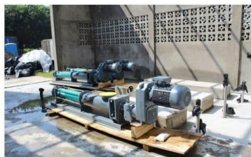
Bombas de lodos primarios.
